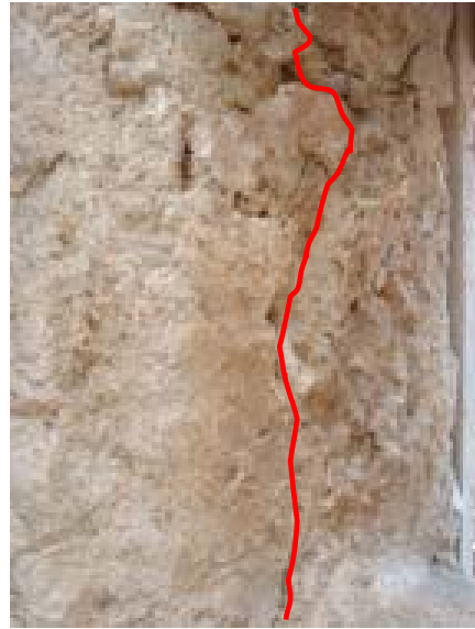
fig. 14 Microlesione verticale nella metà dello spessore murario della Chiesa (stipite interno di una monofora superiore)
